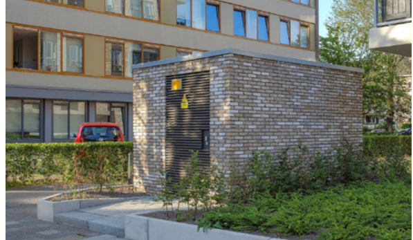
Trafo's in het zicht zijn meeontwerpen met de architectuur
