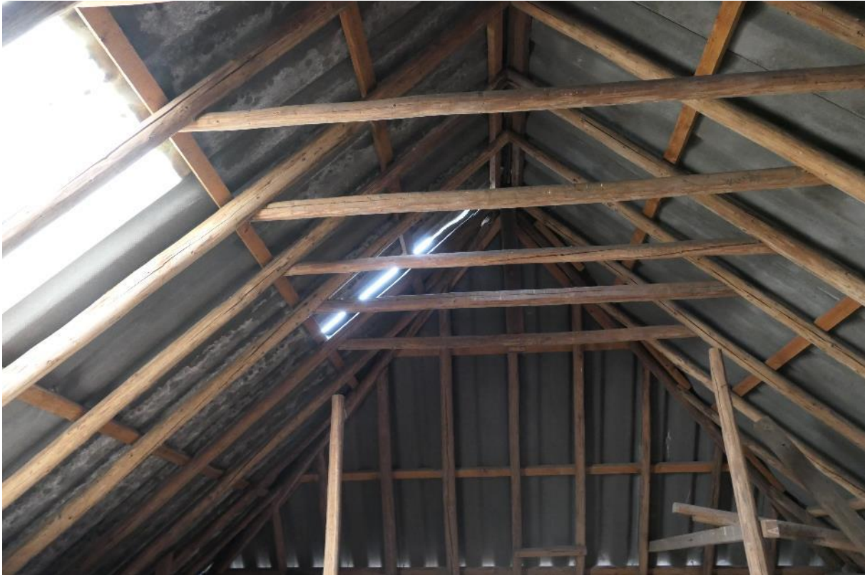
Figuur 4.9 Binnenzijde van de schuur biedt mogelijke verblijfplaats voor vrij hangende vleermuissoorten zoals gewone grootoorvleermuis.
