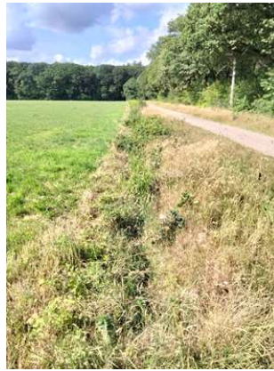
Afbeelding 8. Drooggevallen watergang ter hoogte van de Koeweg
